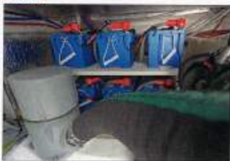
Les six batteries au lithium font partie du pack «grande autonomie» du constructeur.
